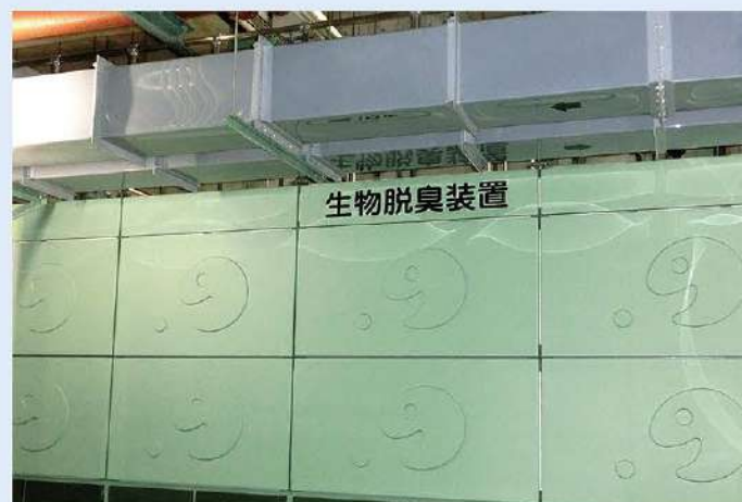
生物脱臭装置
