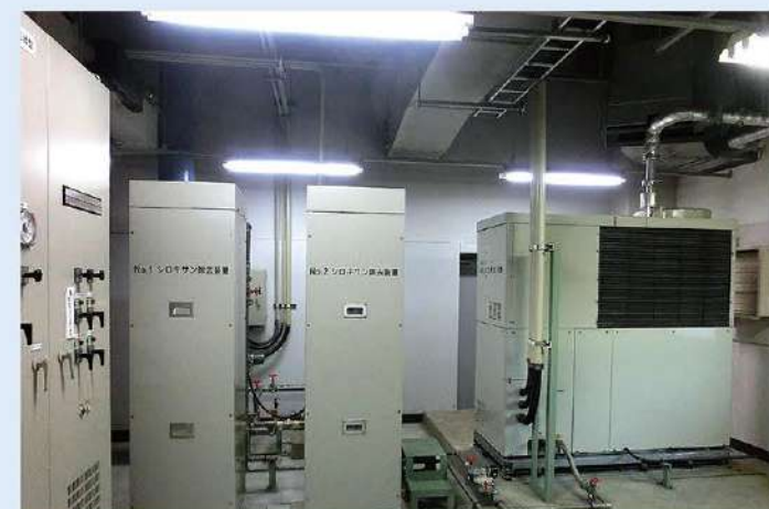
ガス発電装置
